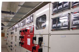
電力裝置 Electrical installation
