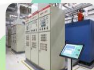
蓄热式电锅炉系统
