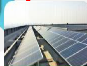
光伏发电系统
