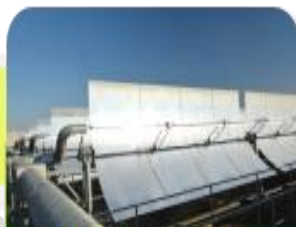
太阳能空调系统
