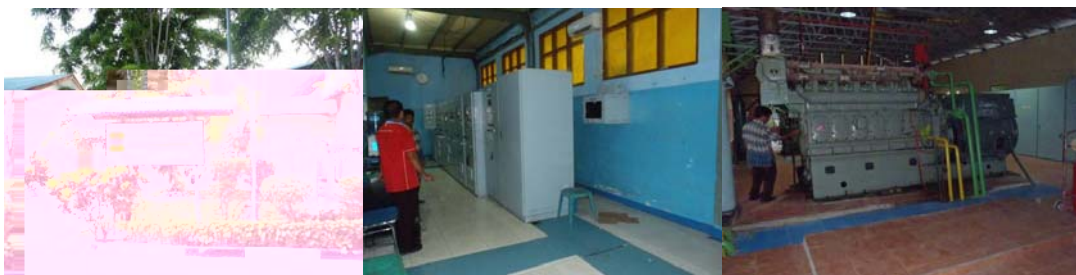
図 3.1.4-2 Waingapu ディーゼル発電所
