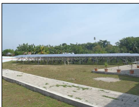
図 3.1.2-3 Bunaken 島の太陽光発電所の外観図
